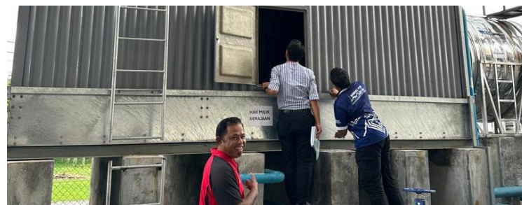
Pemeriksaan Perolehan Pemasangan Cooling Tower bagi Simulasi Kapal di Politeknik Ungku Omar, Perak
